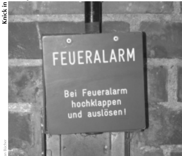
Abdeckung eines Feuermelders, gefunden in einer Turnhalle an der Lichtwiese
